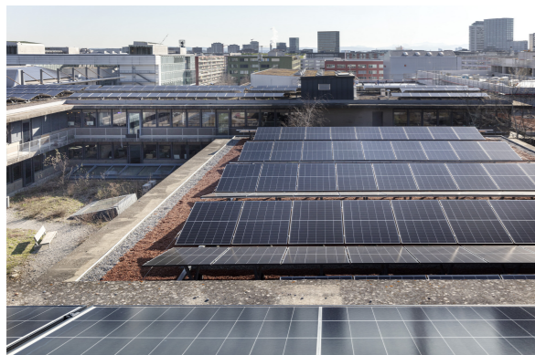
Dachlandschaft mit PV-Anlage
