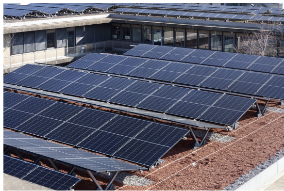
Dachlandschaft mit PV-Anlage
